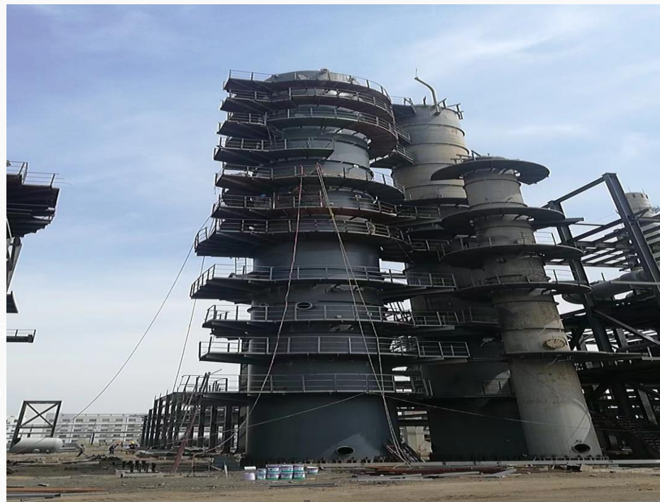
山东广悦化工有限公司 (300万吨/年常减压140万吨/年催化裂化) A、减压塔 \Phi 7200/\Phi 4000 * 50179 , S31603/Q345R。 B、催化分馏塔 \Phi 5000 * 50863 , S11306/Q345R
